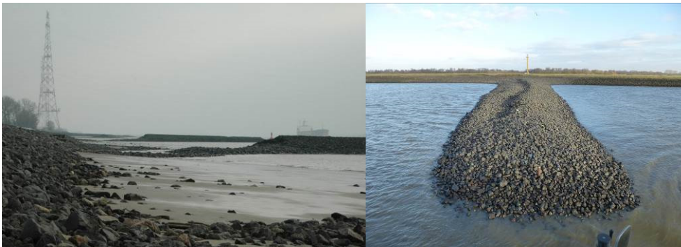
Abb. 1: Durchbruch der Buhnenwurzeln bei Juellssand infolge schiffserzeugter langperiodischer Wellenbelastung (links), Schadensbild trotz optimierter Buhnenform und Bauweise (rechts).
