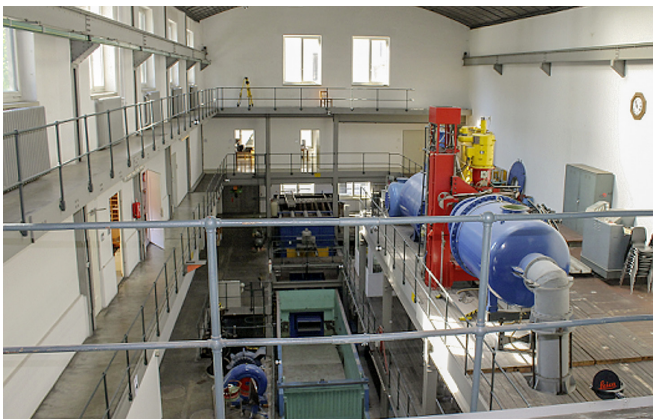
Abb. 11: Das Prüffeld nutzt den freien Raum in der Hallenmitte. Als Standpunkte dienen Stativpunkte auf verschiedenen Ebenen auf den Umläufen und zentralen Konsolen.
